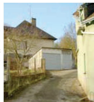
La forme de toit en apentis, les murs en fibrociment et la toiture en tôle ondulée, sont inadaptés.
