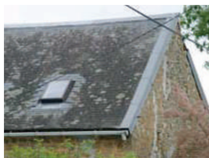
Détail de rive en zinguerie inadaptée pour un bâtiment ancien
