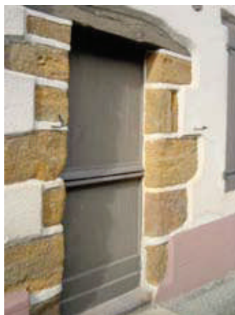
L'enduit réalisé n'arrive pas au nu des pierres d'encadrement, mais est en surépaisseur par rapport au nu de la pierre formant une boursofflure inesthétique.
