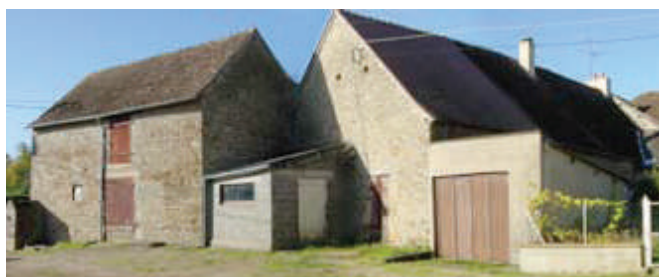
Les appentis ne sont pas en relation avec les volumes principaux, ni dans les mêmes matériaux.
