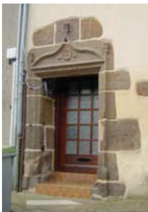
La porte vitrée en bois vernis, est inadaptée à l'architecture de la porte d'une maison du XVI ème siècle.
