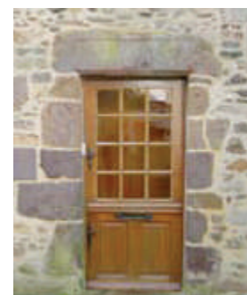
La proportion de la partie vitrée ne correspond pas aux proportions des portes traditionnelles.
