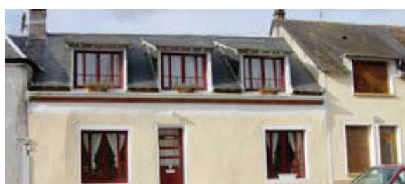
Lucarnes passantes à une pente, de proportion plus large que haute, non harmonieuses.
