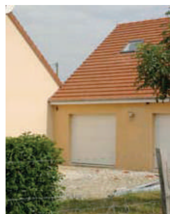
Les baguettes en plastique blanc mises en œuvre dans les angles sur cette maison, sont trop visibles et donnent un aspect trop raide à la maçonnerie.
