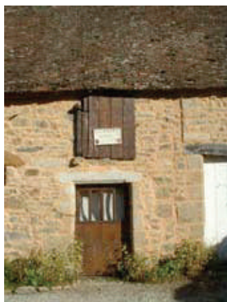
Enduit «à pierres vues » (ou devinées) sur une maçonnerie ancienne, aux tons des sables naturels.
