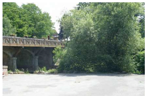
Vue sur la rivière masquée par la végétation non entretenue
