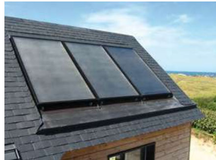
Panneaux noirs sur couverture ardoise
