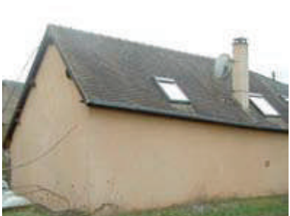
Souche créée trop mince et placée en bas du faîtage
