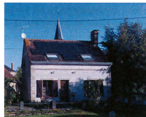
Mauvaise insertion de panneaux photovoltaïque
